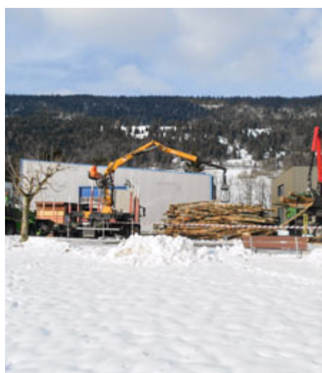
Place de dépôt et déchetage du bois avec la mise des copeaux directement dans le silo du bâtiment de la chaufferie (photo Bühler)
