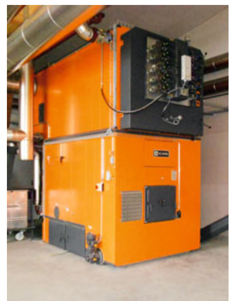
Chaudière (photo Bühler)
